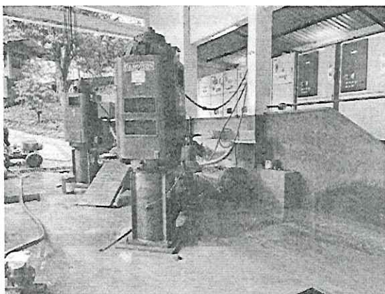
Fotografía 8: Motor en funcionamiento en la casa de máquinas de Bavaria Fuente: EAAV, 2023
