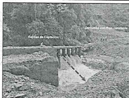
Fotografía 5: Localización de riesgo inminente Fuente: EAAV ESP, 2023
