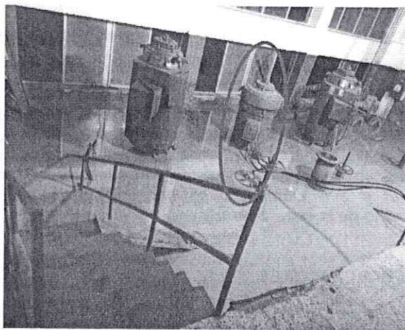
Fotografía 7: Inundación al interior de la estación de Bombeo Fuente: EAAV, 2023
