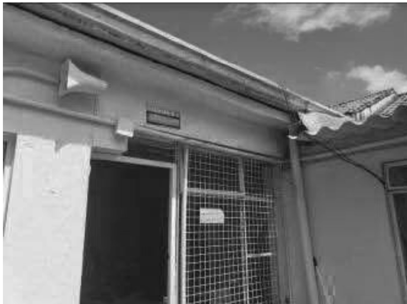
Estado actual de las canales y bajantes
