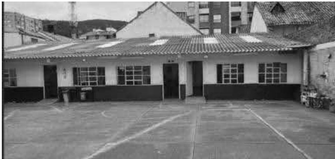
Estado actual de las puertas y ventanas
