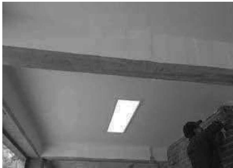
Remates de pintura en techo del pasillo del bloque de salones.
