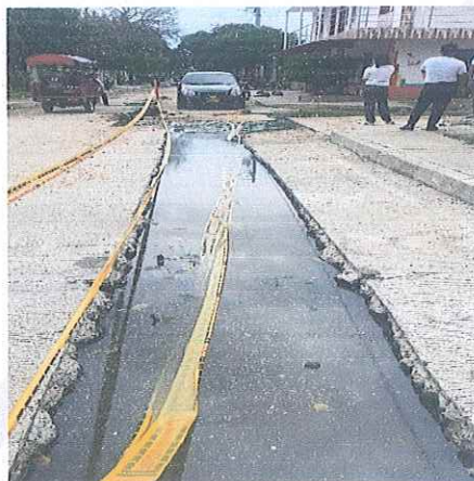
Estado Inicial de la Vía
