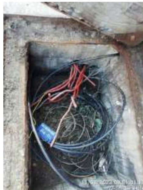
Identificación de vandalismos en cables de control
