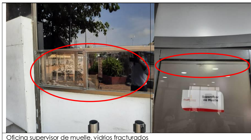
Oficina supervisor de muelle, vidrios fracturados
