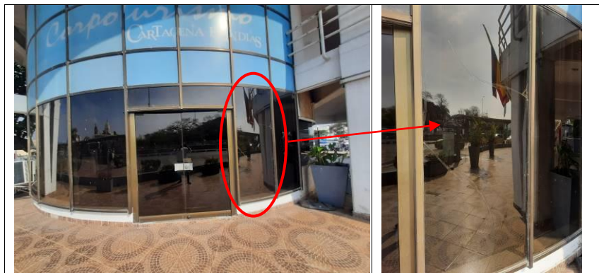
Fachada piso 1 de oficinas, película de polarizado desgastada y en mal estado
