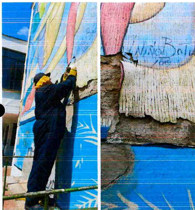
Fotografía 22 y 23 Detalle proceso de readhesión de capa pictórica con desprendimiento
