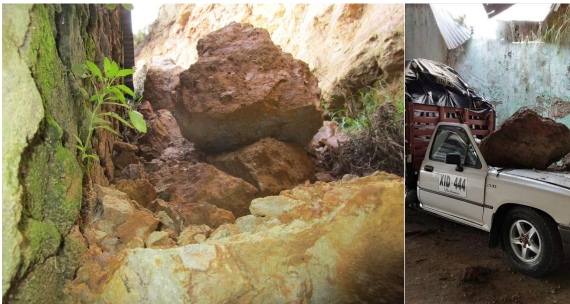
Fotografías 5 y 6. Deslizamiento, caída de rocas y daños producidos por el movimiento.
