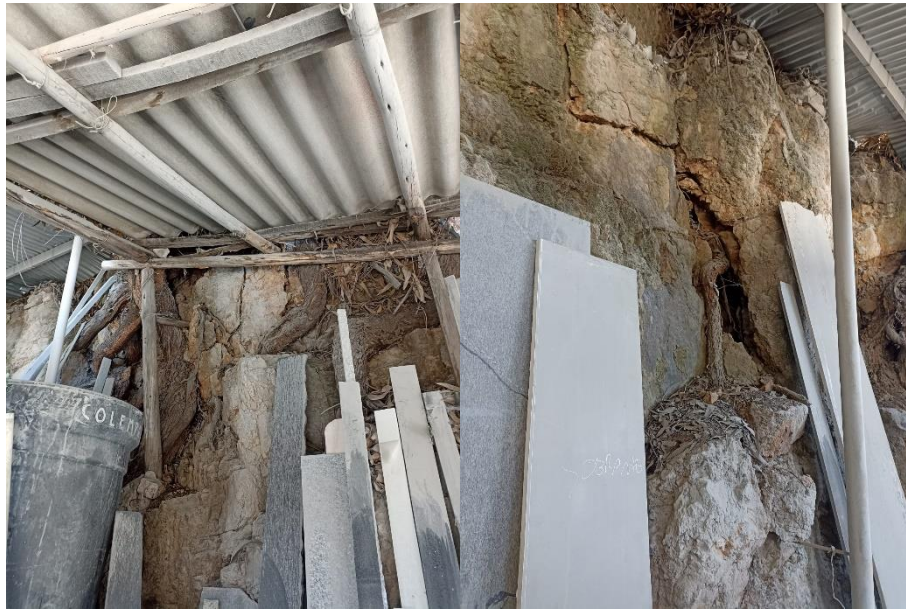
Fotografías 3 y 4. Evidencia de meteorización biológica y fracturación del macizo por raíces.
