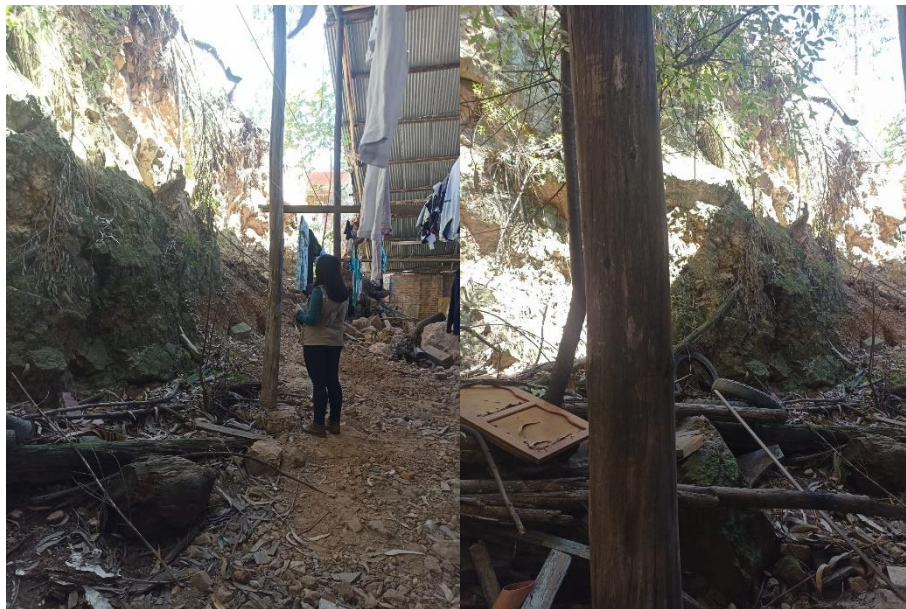
Fotografías 1, 2. Zona con presencia de caída de bloques debido a meteorización biológica generada por raíces de árboles de especie eucalyptus.
