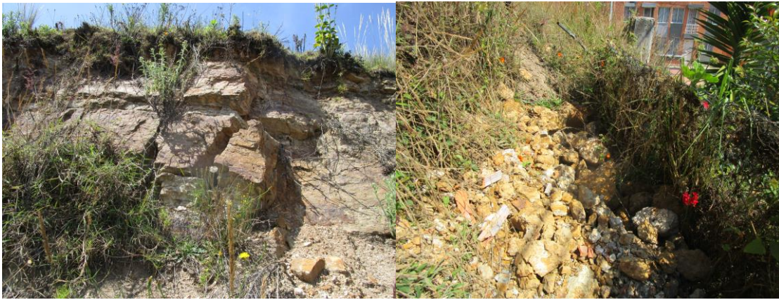
Fotografía 1 y 2. Bloques sueltos producto de la erosión.
