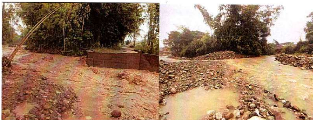
Imagen 565. Creciente de caño sucio que afectó la protección del aproche del puente, Mesetas – Vereda Las Flores, Caño Sucio
