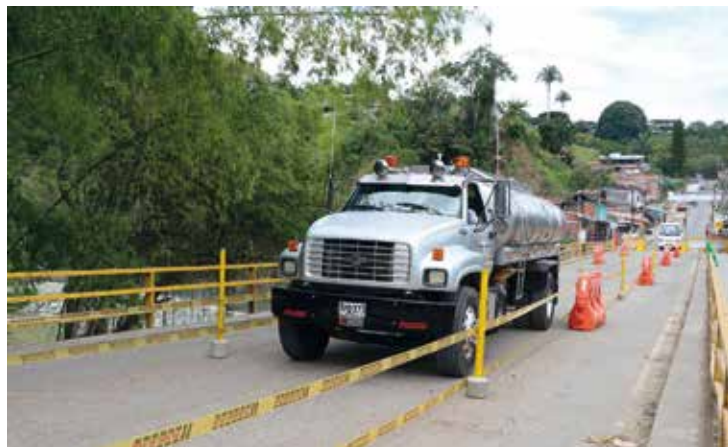
El 29 de diciembre se cumplirán 14 meses del puente Barragán sin estar reforzado 100 %, tras la crecida del río que pasa por debajo y le afectó uno de sus pilares.
