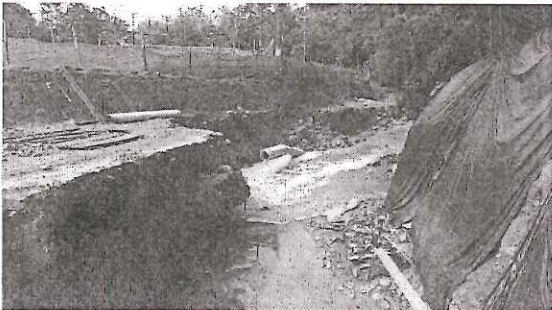
Figura 1. Pérdida parcial de de talud contiguo la pista de BICICROS
