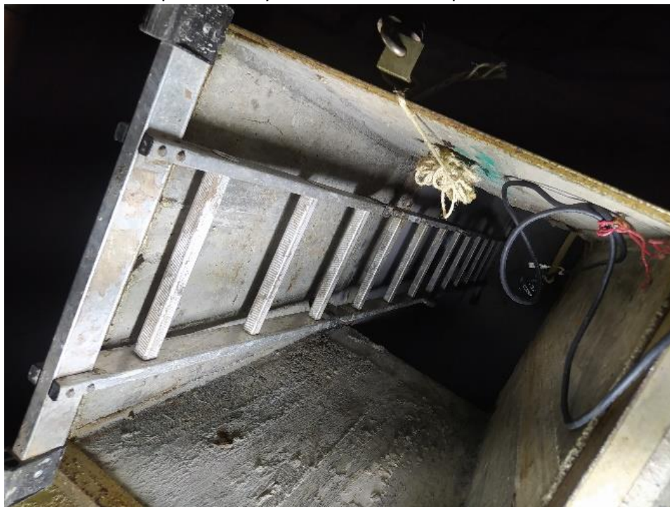
Sistema de acceso para lavado y desinfección del tanque
