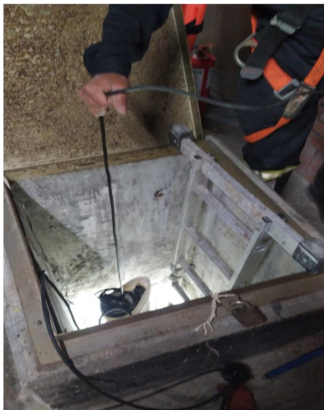
Ingreso de la bomba al tanque de reserva
