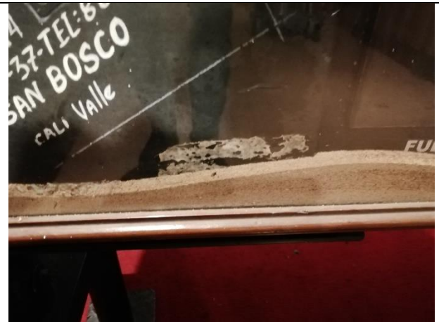
Fotografía 2. Detalle de la evidencia del deterioro producido por las termitas
