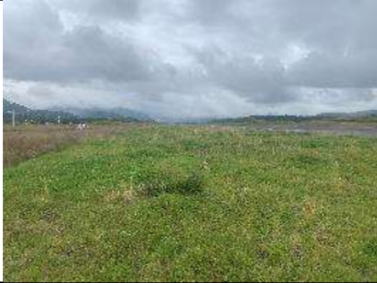
Figura 11. Cabecera 02 Sur. Vista hacia el sur. Franja de seguridad terminada a nivel de césped, observe la irregularidad de la superficie.
