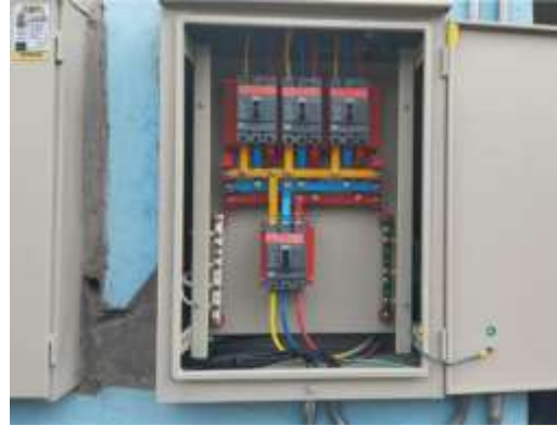
Barrajes, Fases, Protecciones, Neutro, tierra de Tablero de Conexión
