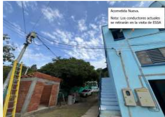
Acometida eléctrica trifásica en cable Cu 3 N.º 4 + 1 N.º 6 + 1 N.º 8, instalada.
