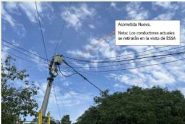
Acometida eléctrica trifásica en cable Cu 3 N.º 4 + 1 N.º 6 + 1 N.º 8, instalada.
