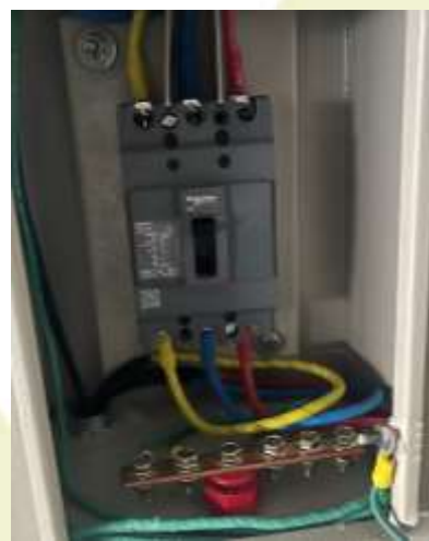
Protecciones AC – SFV2 – Cableados – Circuito de alimentación
