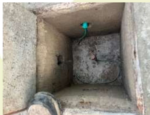
Sistema de puesta a tierra finalizado
