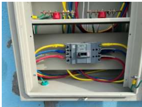
Protección sistema de medida
