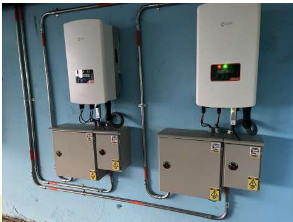
Cableado y conectores (circuitos DC), tubería, protecciones de DC y AC sobre corriente y sobre tensión, circuitos de alimentación, inversores SFV1 y SFV2 y con el enlace Wifi para monitoreo remoto.
