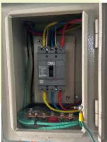
Protecciones AC – SFV1 – Cableados – Circuito de alimentación
