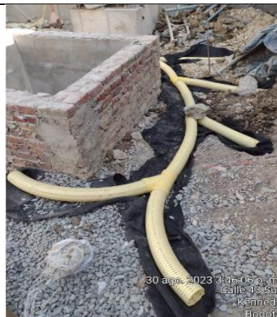
Filtro Frances rampa vehicular.
