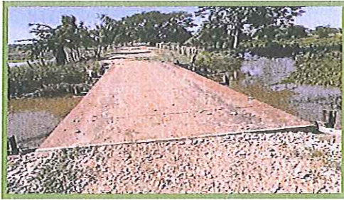
Fotografía 1. Estado de las vías en el sector norte.
