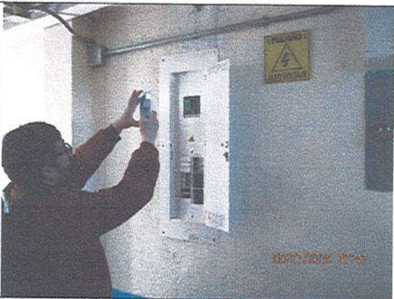
Fotografía No. 4: Tableros y red exterior
