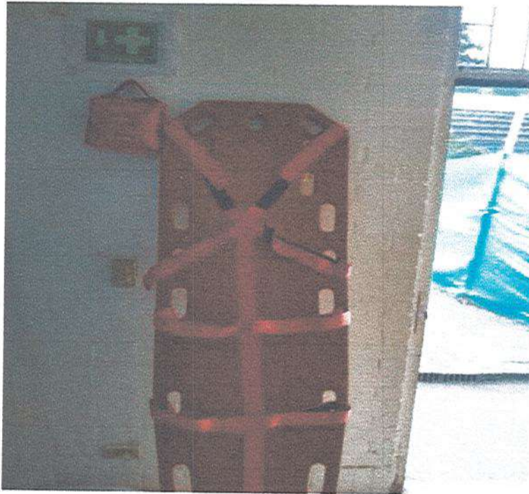
Fotografía 31. Equipamiento requerido en caso de emergencia (Camilla, Extintor, Botiquín) Colegio La Belleza Los Libertadores
