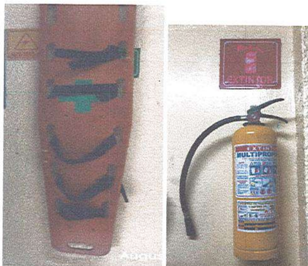
Fotografía 30. Equipamiento requerido en caso de emergencia (Camilla, Extintor, Botiquín) Colegio Altamira
