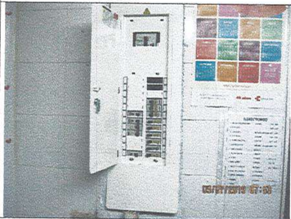
Fotografía No. 3: Tablero interior cocina repotenciado
