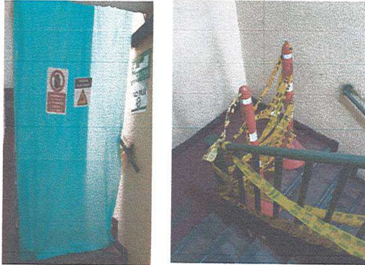
Fotografía 23. Cerramiento a la entrada de las escaleras 2° piso
