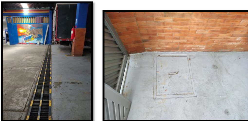
Fotografía 3 Canales colectores y trampa de grasas en el establecimiento
