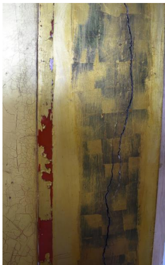
Deterioros e intervenciones parciales
