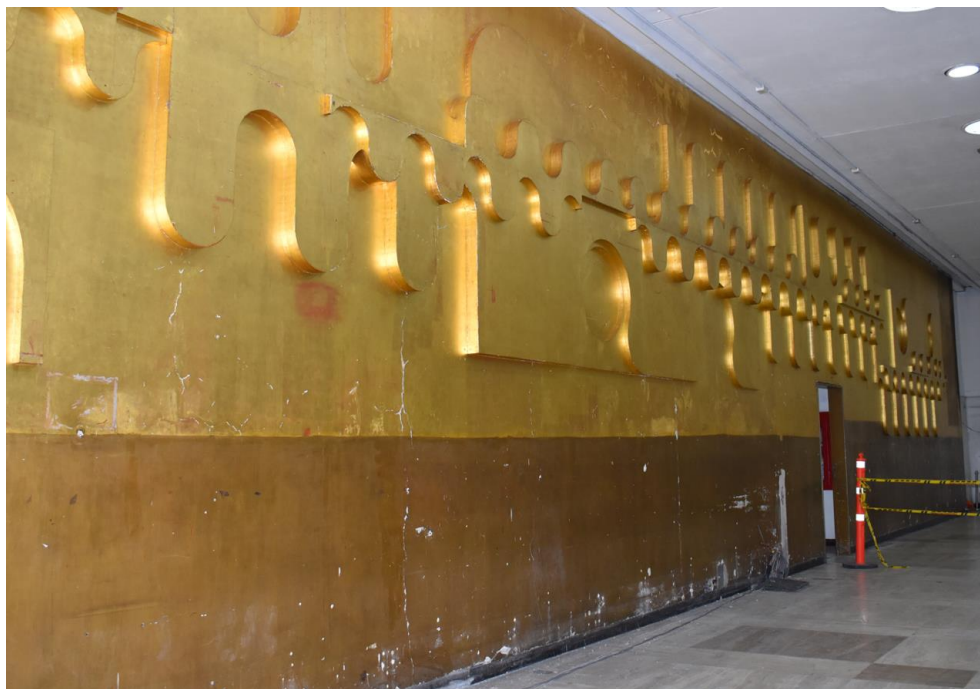
Franja de color originada por intervenciones de baja calidad (purpurina a base de resina sintética). Se observa actualmente como una capa café cobriza, sucia y dispareja
