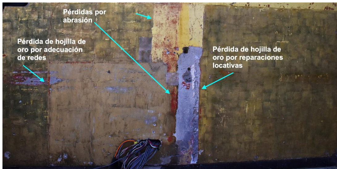
Pérdida significativa de hojilla de oro, producto de la adecuación de redes
