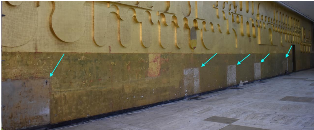
Pérdida significativa de hojilla de oro, producto de la adecuación de redes
