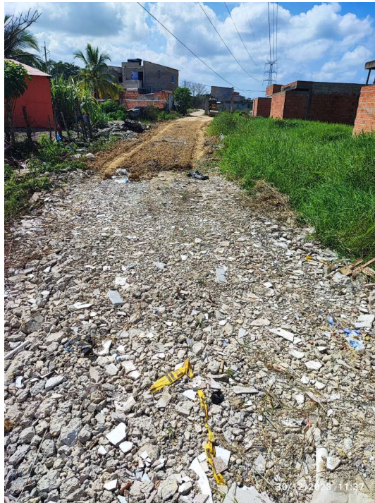
RELLENO CON ESCOMBROS EXISTENTE
