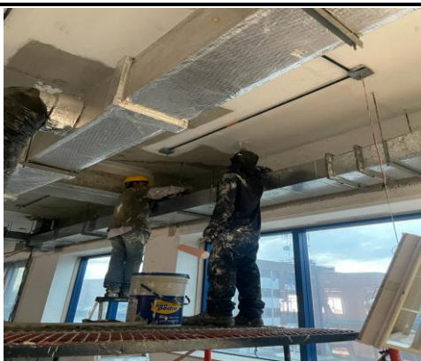
Pintura en la placa en el piso 3 del edificio DELCOP
