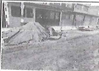
Acopio de escombros en obra
