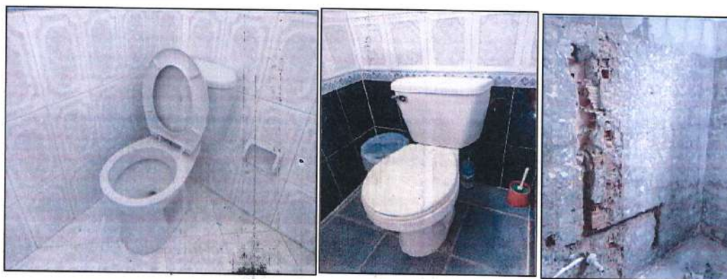
Imagen 59. Desmante de baño social segundo piso y baño planeación.
