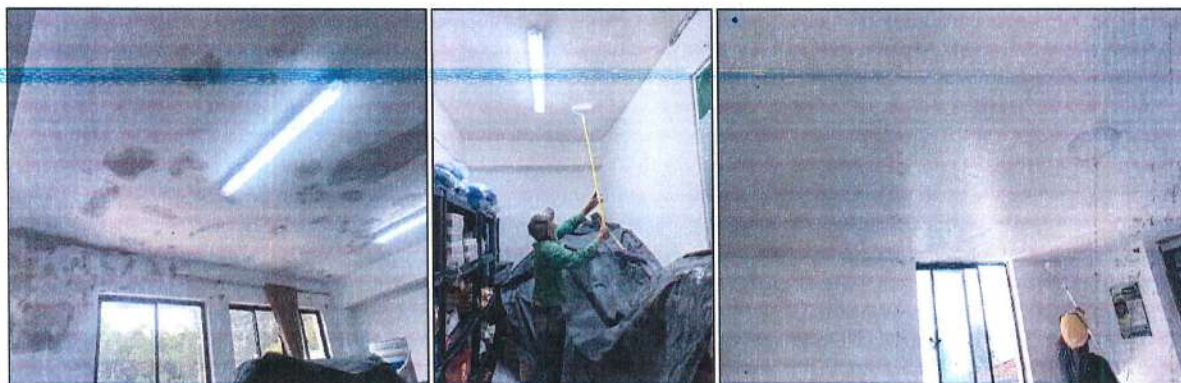
Imagen 28. Pintura de muros y placa con humedades posterior a estucado y lijado.
