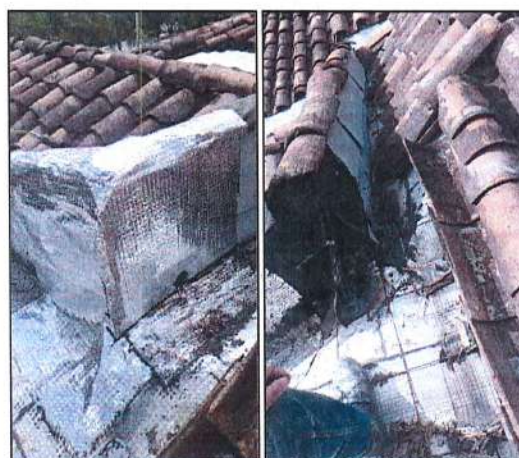
Imagen 40. Impermeabilización de canal en concreto, bajantes en cubierta por humedades.
