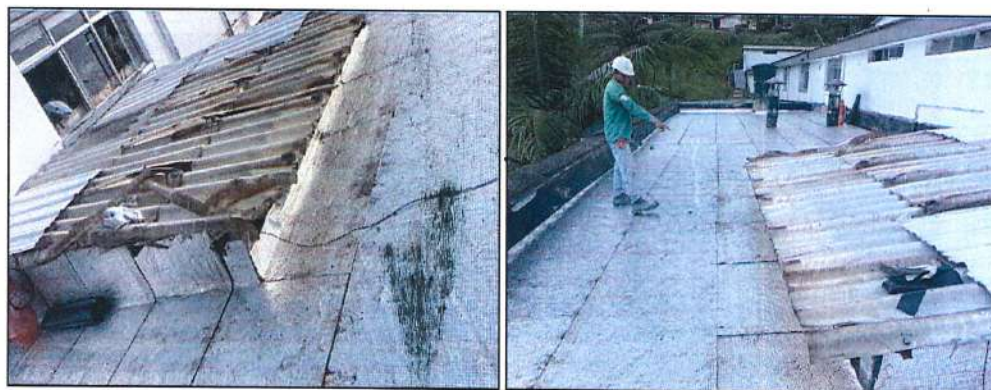
Imagen 24. Cubierta en PVC existente en mal estado.
