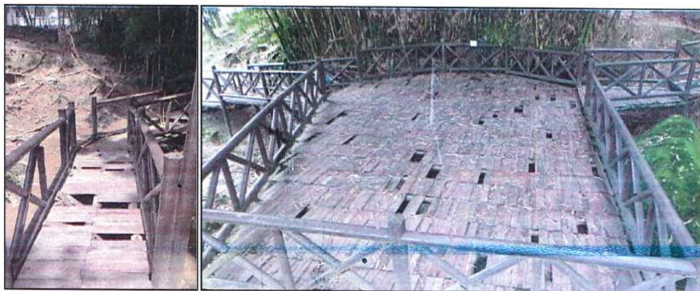
Imagen 29. Condiciones iniciales del mulle - estado en abandono
