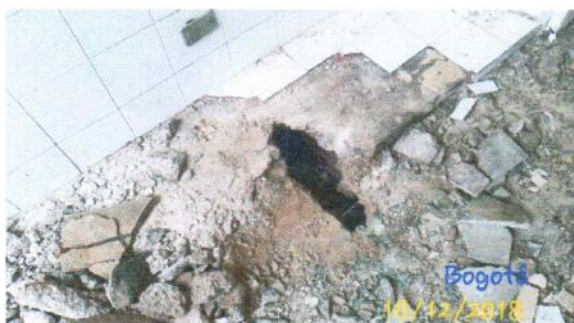
Foto 11: Se detecto placa falsa cerca a caja sanitaria
