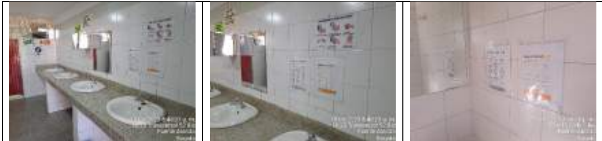
Fotografía 19. Señalización protocolo de bioseguridad en obra IED Luis Carlos Galán
