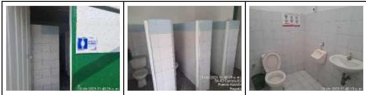
Fotografía 34. Batería de Baño IED Silveria Espinosa
