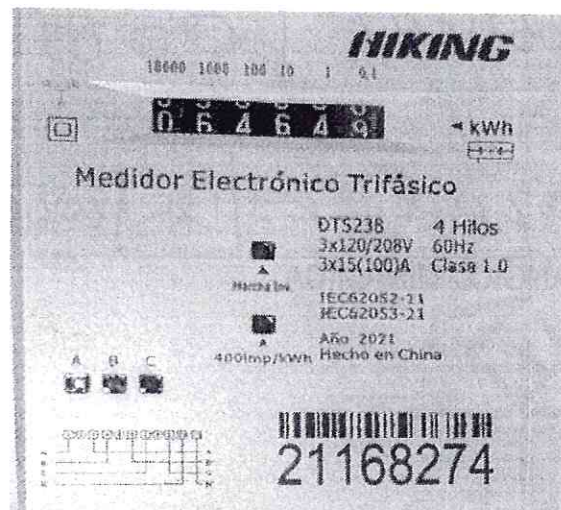
MEDIDOR ENERGÍA TABLERO PRIMER PISO
