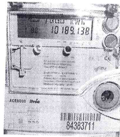
MEDIDOR ENERGÍA SUBESTACION
