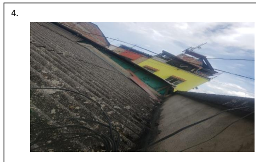
Descripción revision de cubierta que requiere mantenimiento
