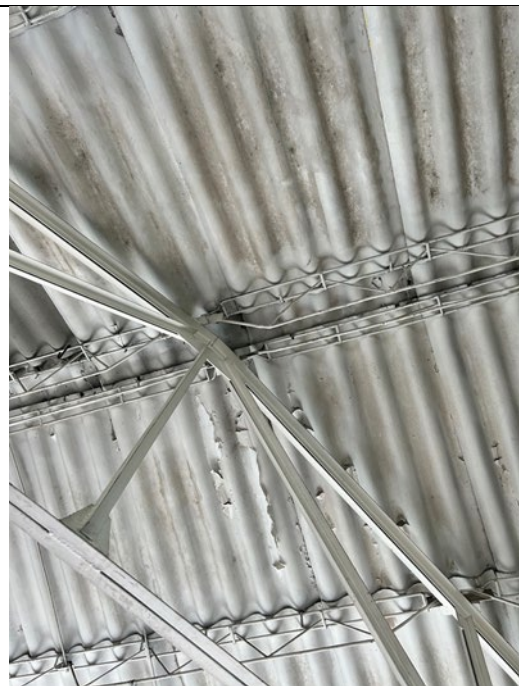
ESTADO ACTUAL DE AULAS CON TEJA EN ABESTECIMIENTO
