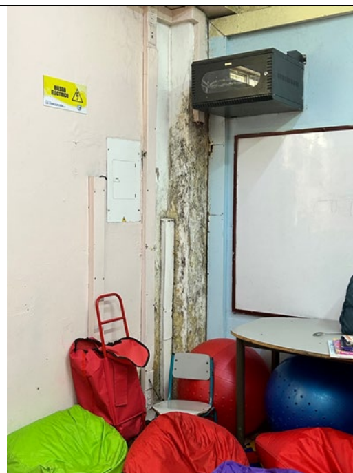
ESTADO ACTUAL HUMEDAD EN AULAS
