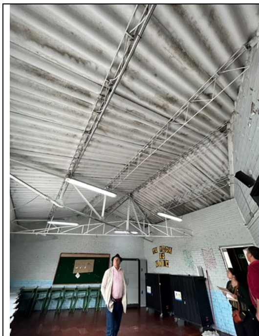
ESTADO ACTUAL DE AULAS CON TEJA EN ABESTECIMIENTO
