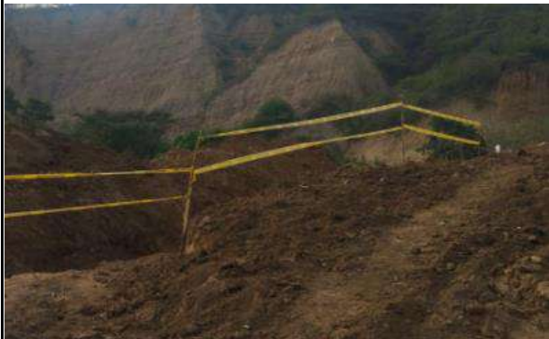
Señalización de Seguridad
