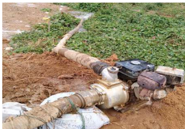
Manejo de agua filtrada en tubería de 54"
