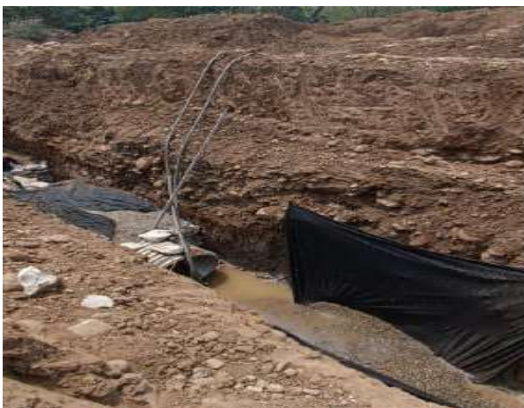
Manejo de aguas lluvias
