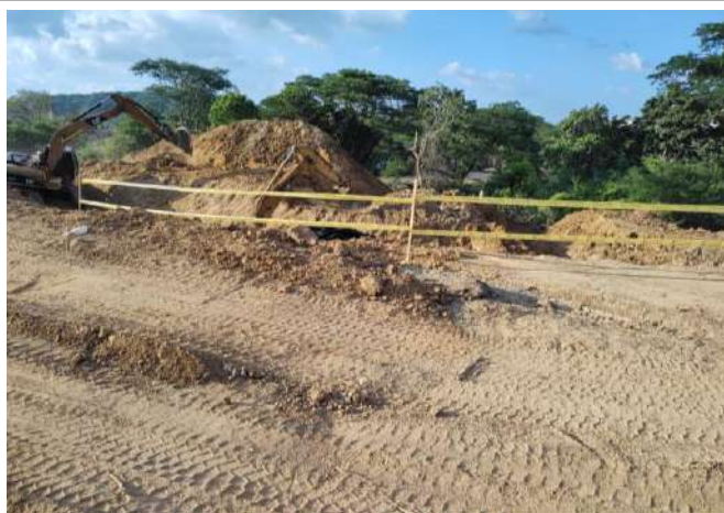
Señalización Seguridad doble linea
