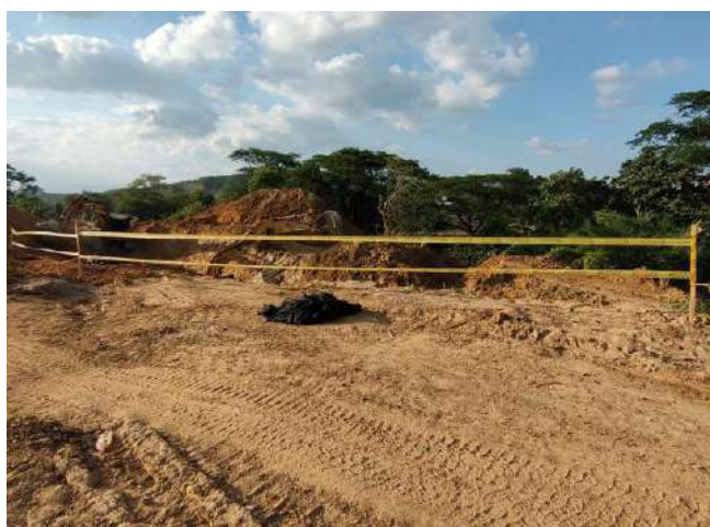
Señalización Seguridad doble linea
