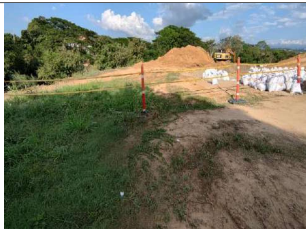
Señalización Seguridad doble linea
