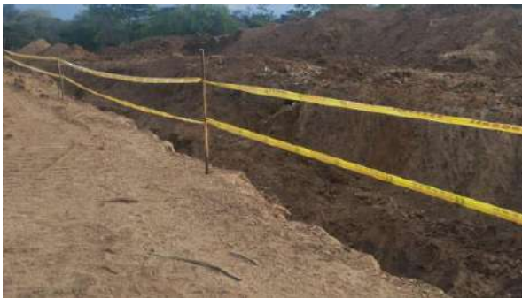
Señalización de Seguridad
