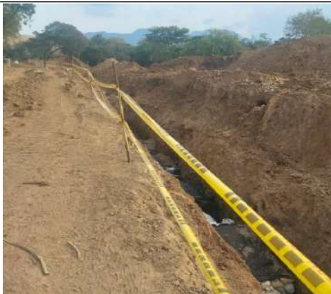
Señalización de Seguridad
