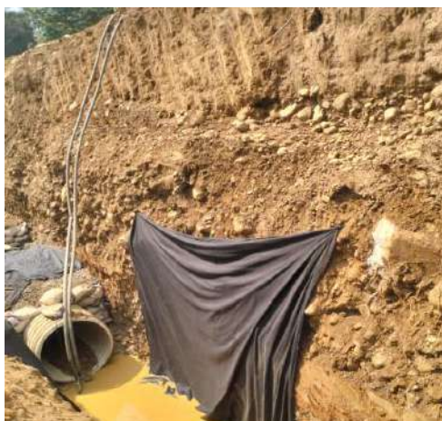
Manejo de agua filtrada en tubería de 48"
