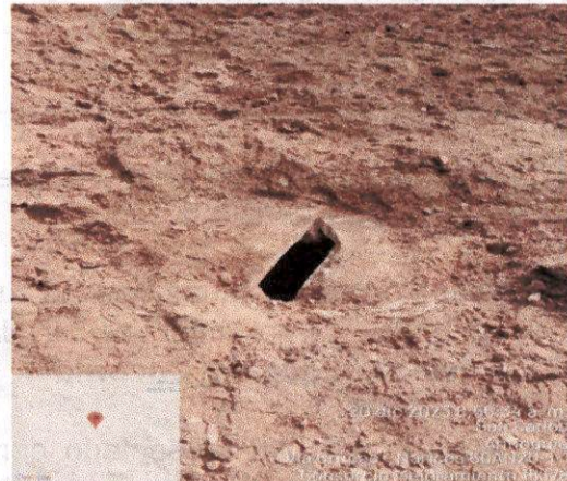
Foto 46. Obra transversal fisurada K19+020.
