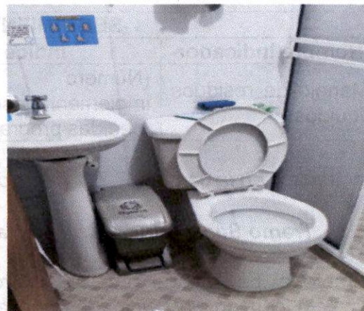
Foto 52. Unidad Sanitaria Fijas en el punto de atención al usuario.
