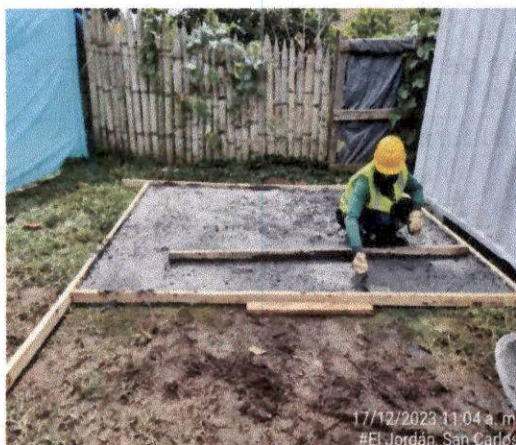
Foto 69. Loza de concreto para acopio de sustancias químicas K19+640 (derecho).
