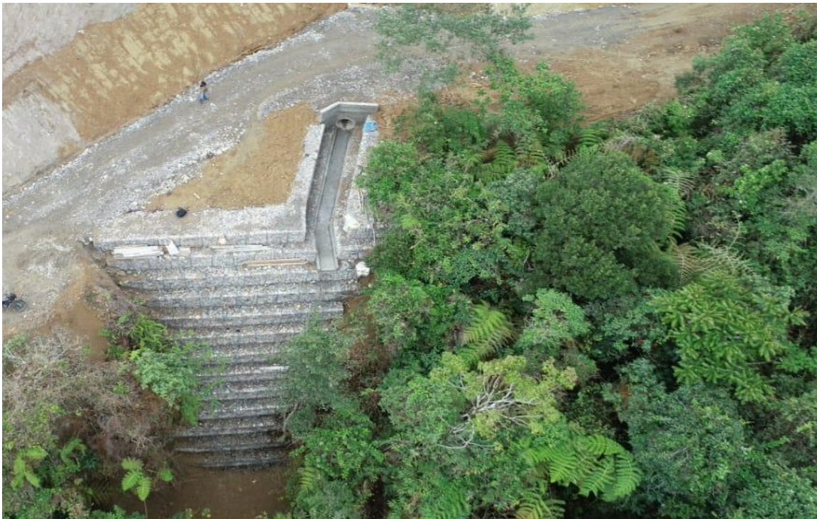
K1+600 Vía terciaria Colón – Vergel de Fátima, Municipio de Colón.
