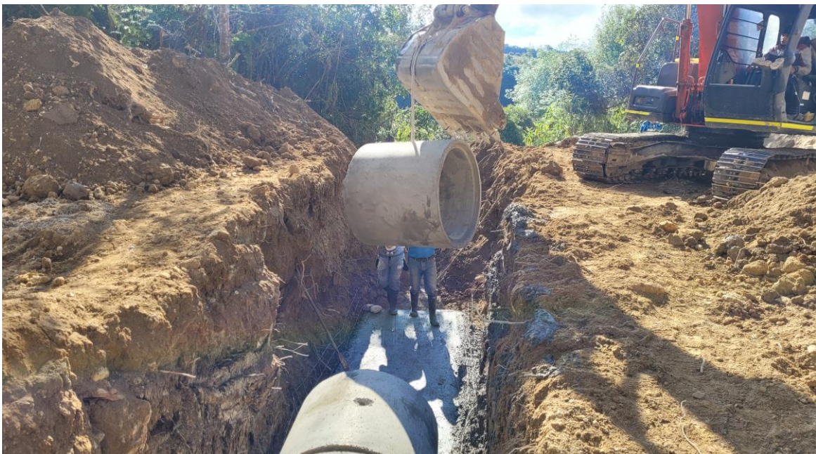
K1+600 Vía terciaria Colón – Vergel de Fátima, Municipio de Colón.
