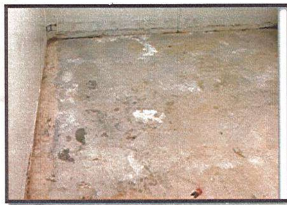
ESTADO ACTUAL DE PLACA CUARTO FRIO REFRIGERACIÓN
