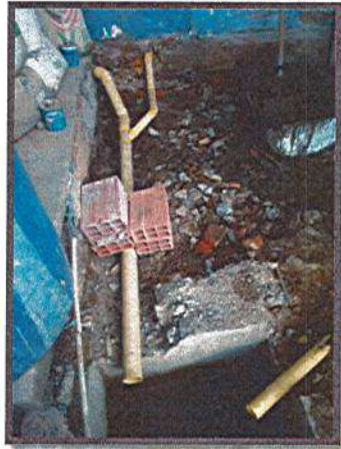
TUBERIA HIDROSANITARIA Y CAJA DE INSPECCIÓN
