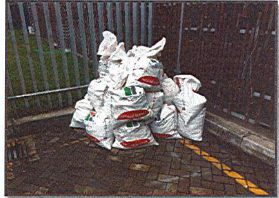
ACOPIO DE MATERIAL ESCOMBRO
