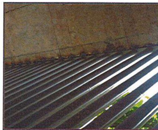
DETALLES A CORREGIR POR PARTE DE CONTRATISTA
