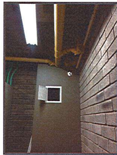
REGISTRO PARA TUBERIA NUEVA-CUARTO ELECTRICO
