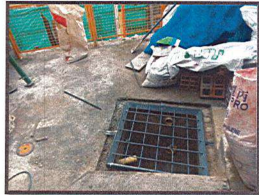
CAJA DE INSPECCIÓN
