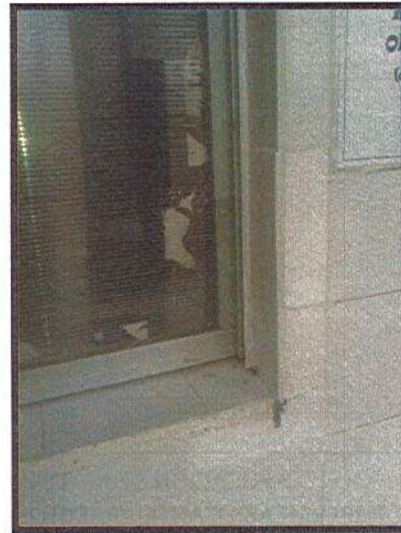
ARREGLO DE ENCHAFE DAÑADO- EXTERIOR COCINA
