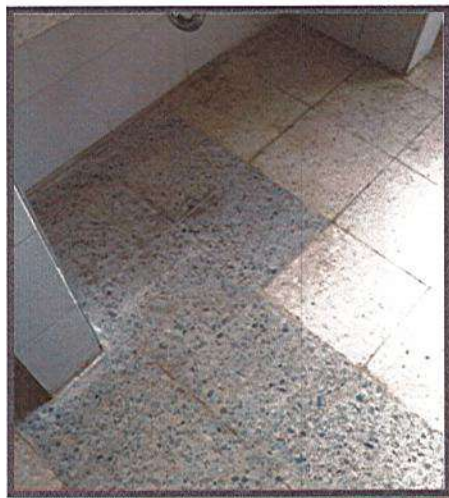
REPOSICION DE BALDOSA
