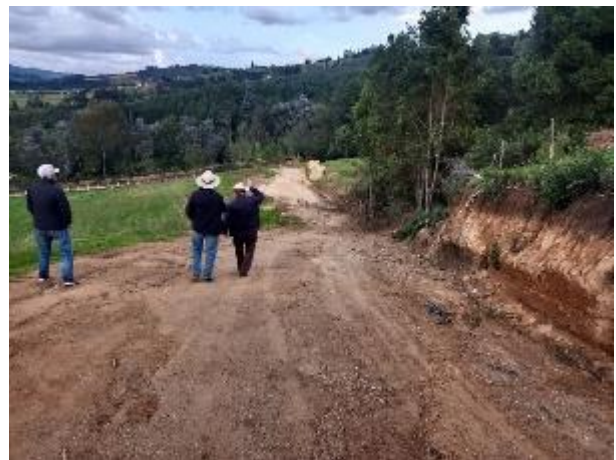
Ilustración 7. Estado inicial de la vía. Vereda Centro.
