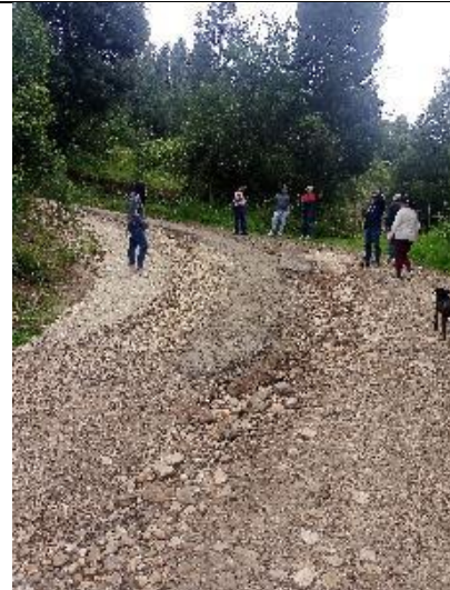
Ilustración 5. Estado inicial de la vía. Vereda San Antonio.
