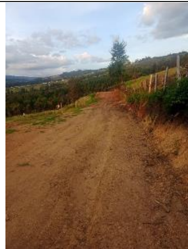
Ilustración 9. Estado inicial de la vía. Vereda Centro.
