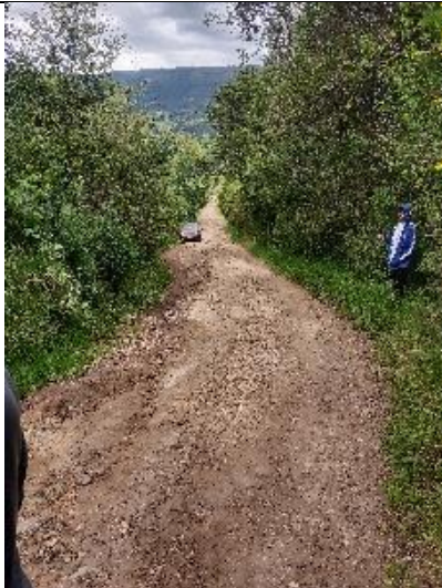
Ilustración 4. Estado inicial de la vía. Vereda San Antonio.
