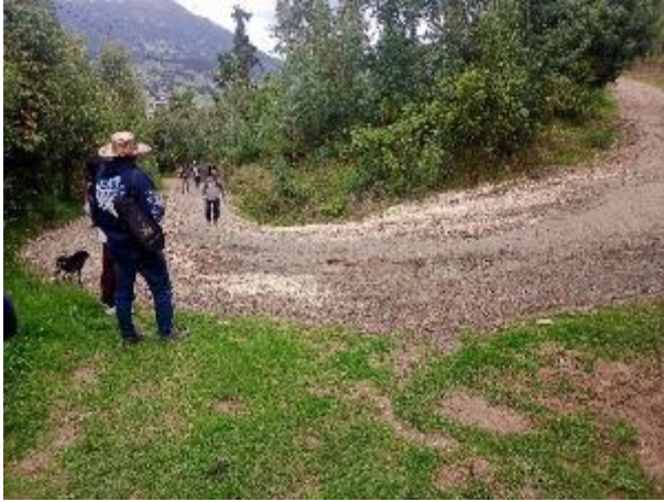
Ilustración 2. Estado inicial de la vía. Vereda San Antonio.
