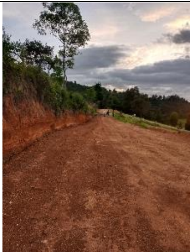
Ilustración 8. Estado inicial de la vía. Vereda Centro.
