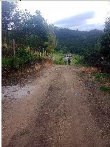
Ilustración 6. Estado inicial de la vía. Vereda Centro.
