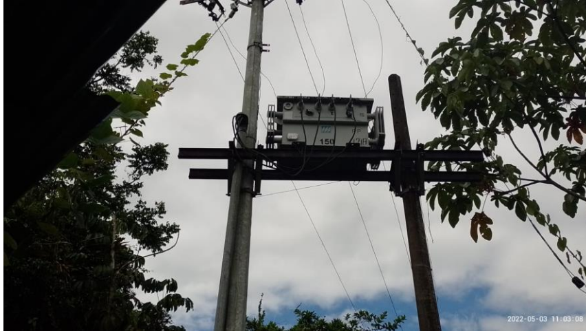
Imagen No 5 Transformador de potencia
