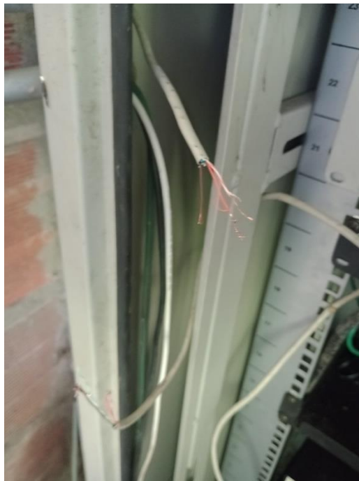
Imagen # 9 cable de comunicaciones cortado
