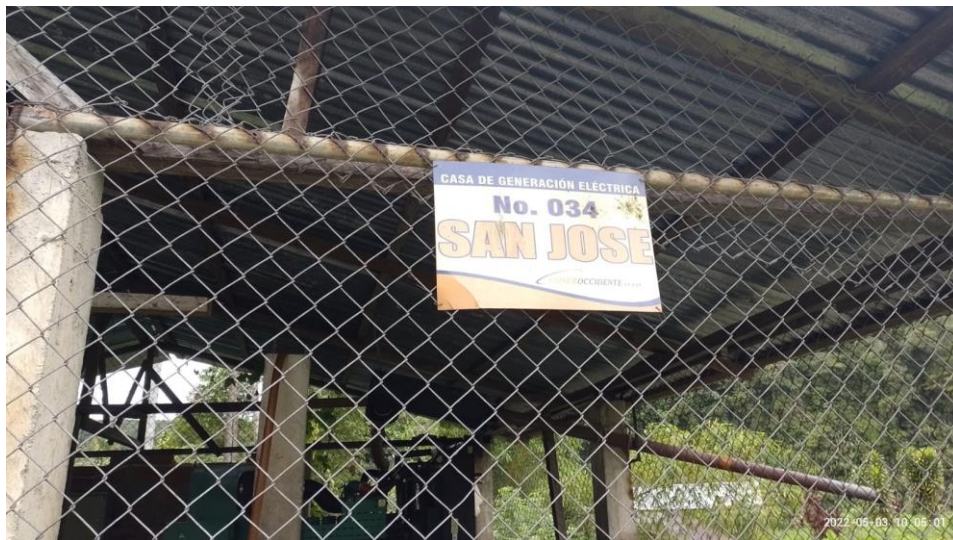
Imagen No 2 instalación física planta de generación
