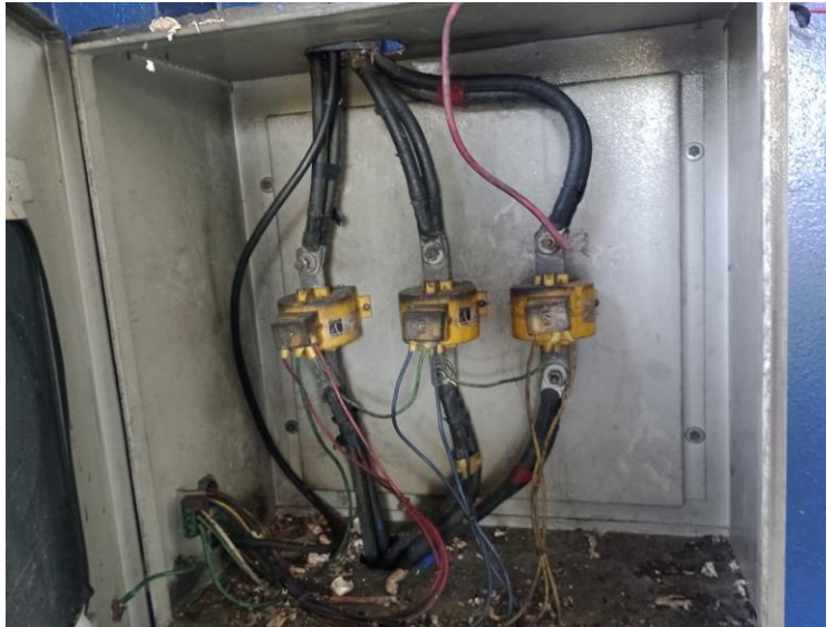
Imagen No 5 Transformadores de corriente
