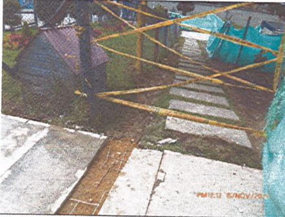
Fotografía No. 3: Cruce red eléctrica – alimentación cocina móvil.
