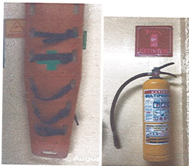
Fotografía 29. Equipamiento requerido en caso de emergencia (Camilla, Extintor, Botiquín) Colegio Altamira
