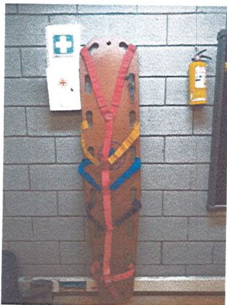
Fotografía 28. Equipamiento requerido en caso de emergencia (Camilla, Extintor, Botiquín) Colegio La Giralda
