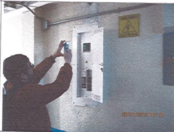
Fotografía No. 4: Tableros y red exterior
