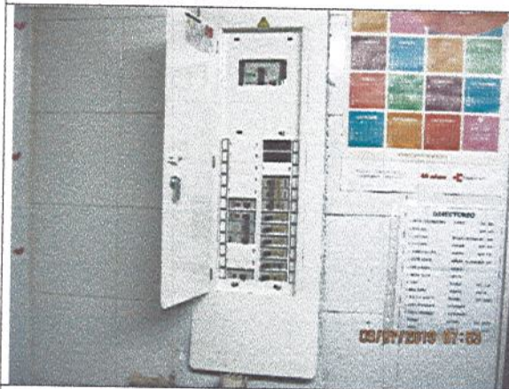
Fotografía No. 3: Tablero interior cocina repotenciado
