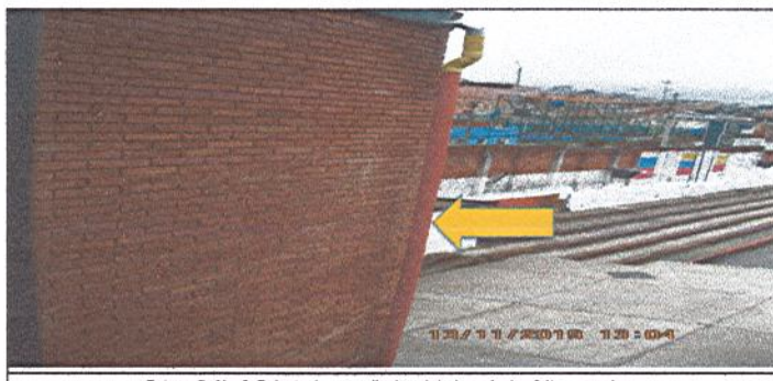
Fotografía No. 6: Bajante de aguas lluvias - interior colegio - falta agarraderas
