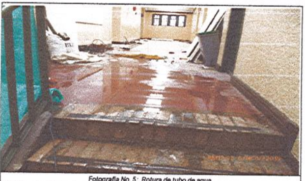
Fotografía No. 5: Rotura de tubo de agua
