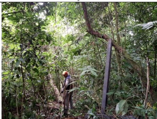
Foto 58. Ahoyado para postes
