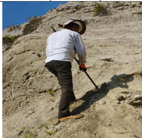
Foto 91. Ahoyado para postes
