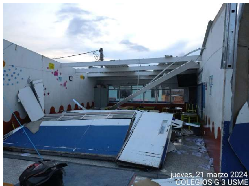
Ilustración 2 Estado en el momento de atención de la emergencia.
