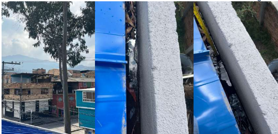
Ilustración 11 Estado actual viga canal.
