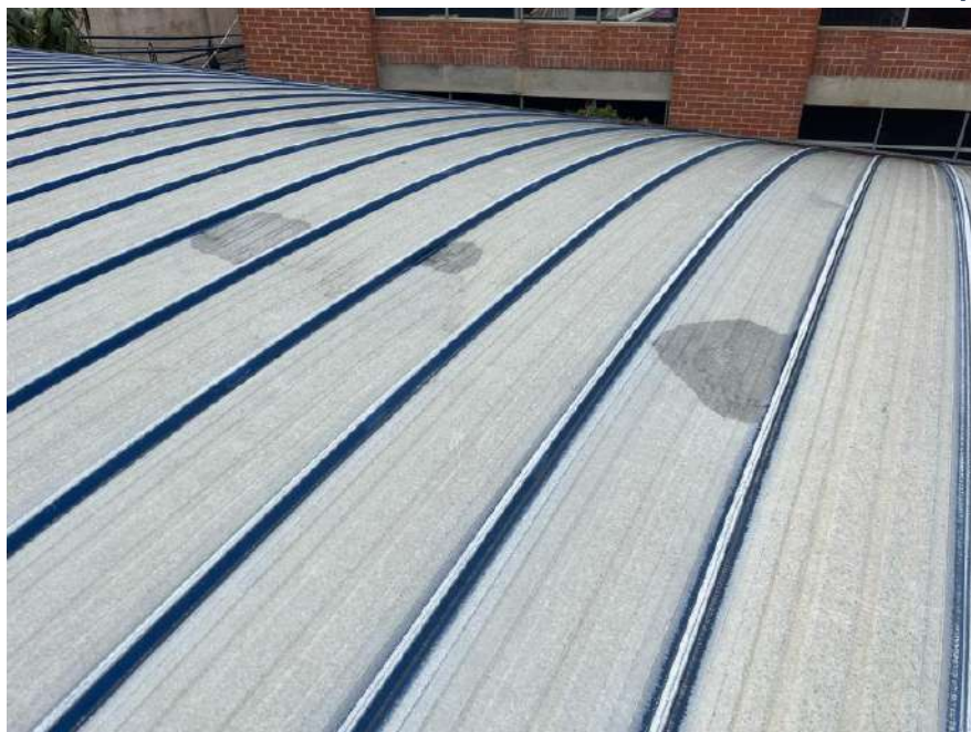
Ilustración 6 Hundimientos a nivel de cubierta.
