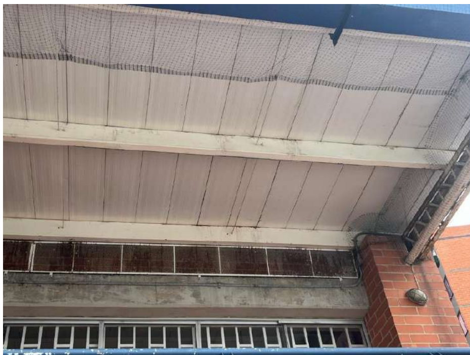
Ilustración 14 Marcas de filtración de agua.
