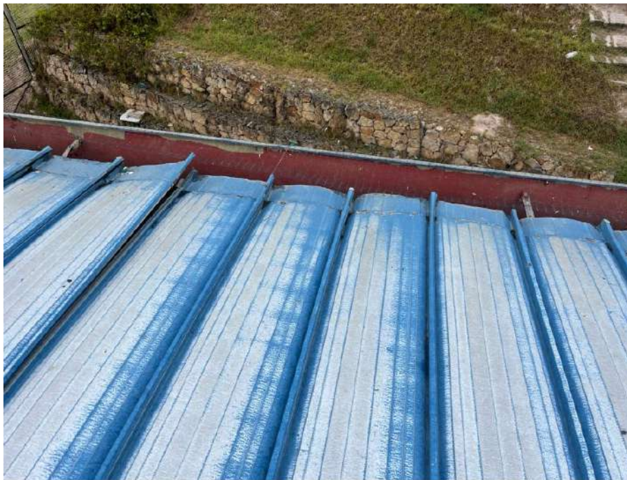
Ilustración 12 Desgrafado segunda capa panel metálico.
