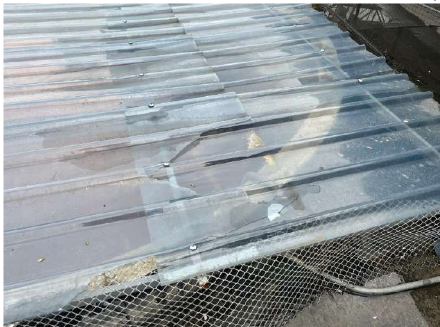
Ilustración 10 Fracturación y desprendimiento de cubierta.
