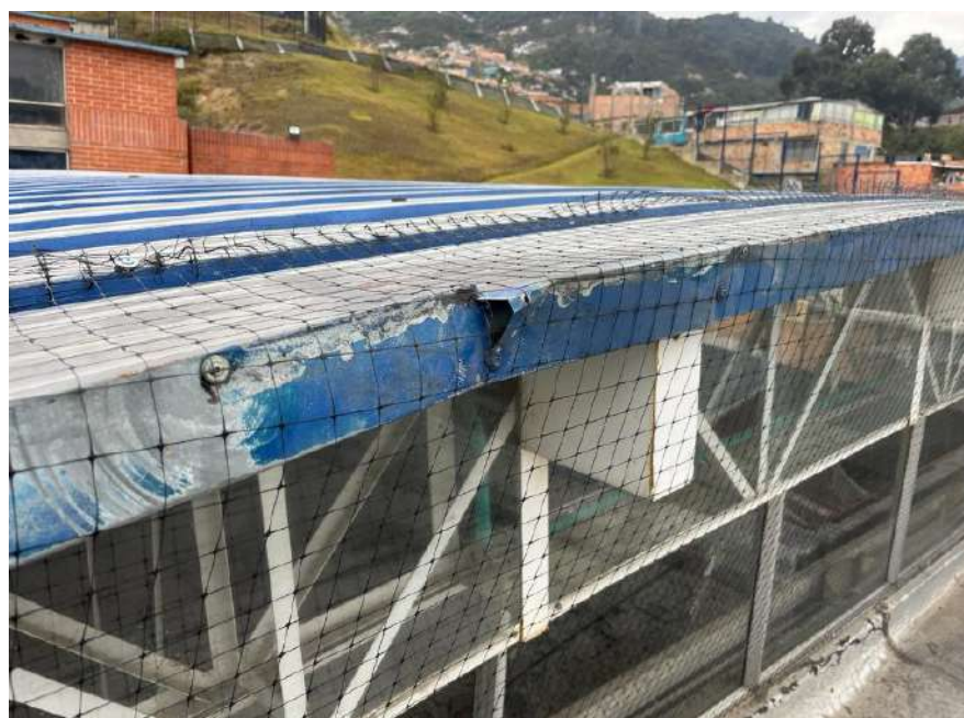
Ilustración 7 Desprendimiento de remates a nivel de cubierta.
