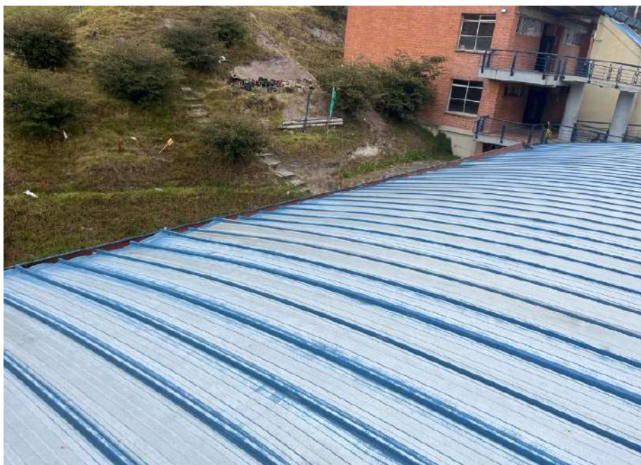
Ilustración 11 Desgrafado segunda capa panel metálico.
