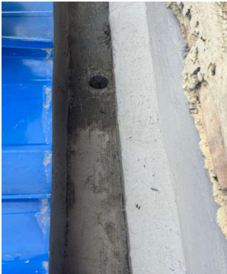
Ilustración 8 Bajante existente en 2 pulgadas.
