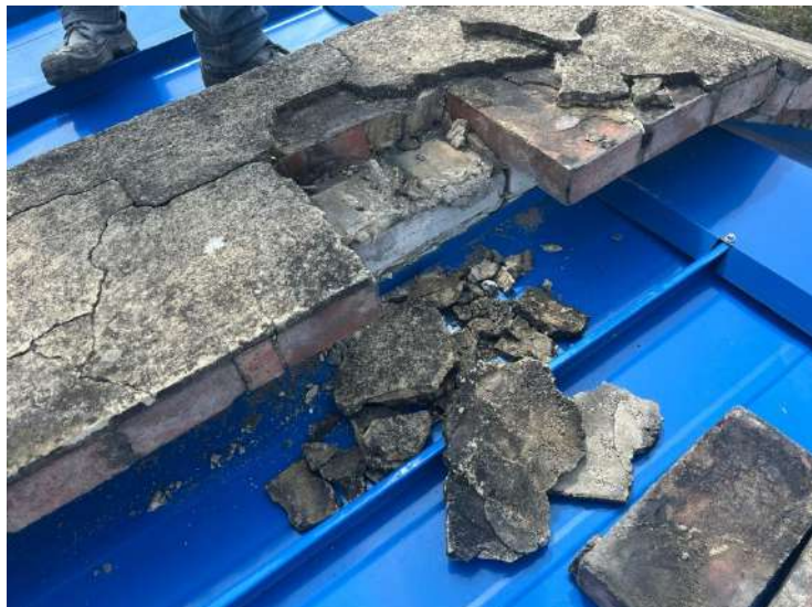
Ilustración 9 Desprendimiento remate muros.
