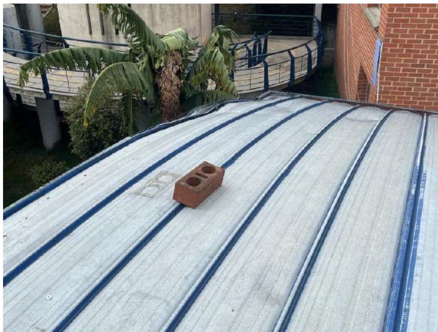
Ilustración 5 Hundimientos y desprendimiento remates a nivel de cubierta.
