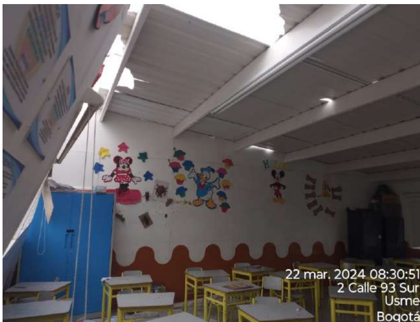
Ilustración 3 Estado en el momento de atención de la emergencia.
