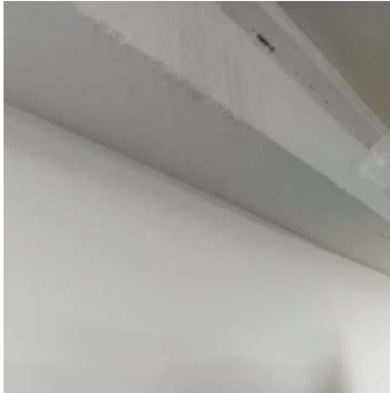
Ilustración 5 Filtración rebose viga canal día 20 marzo 2024.
