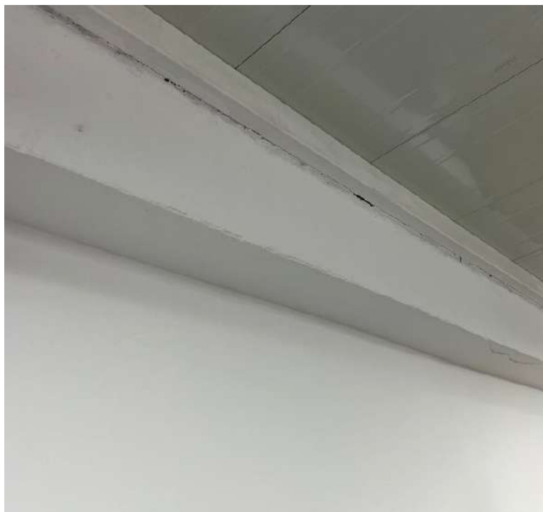
Ilustración 6 Área de filtración viga canal día 21 marzo 2024.
