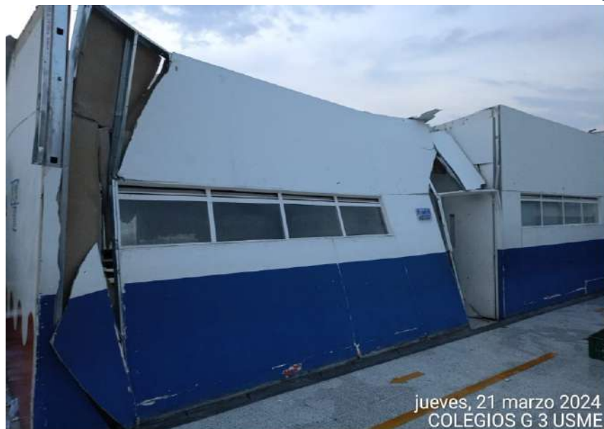
Ilustración 1 Estado en el momento de atención de la emergencia.
