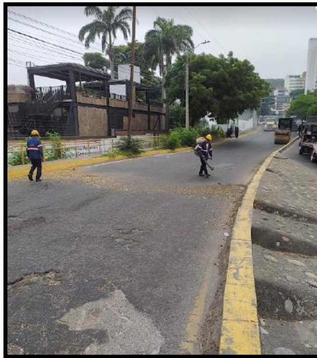
Registro fotográfico N°: Actividad:
