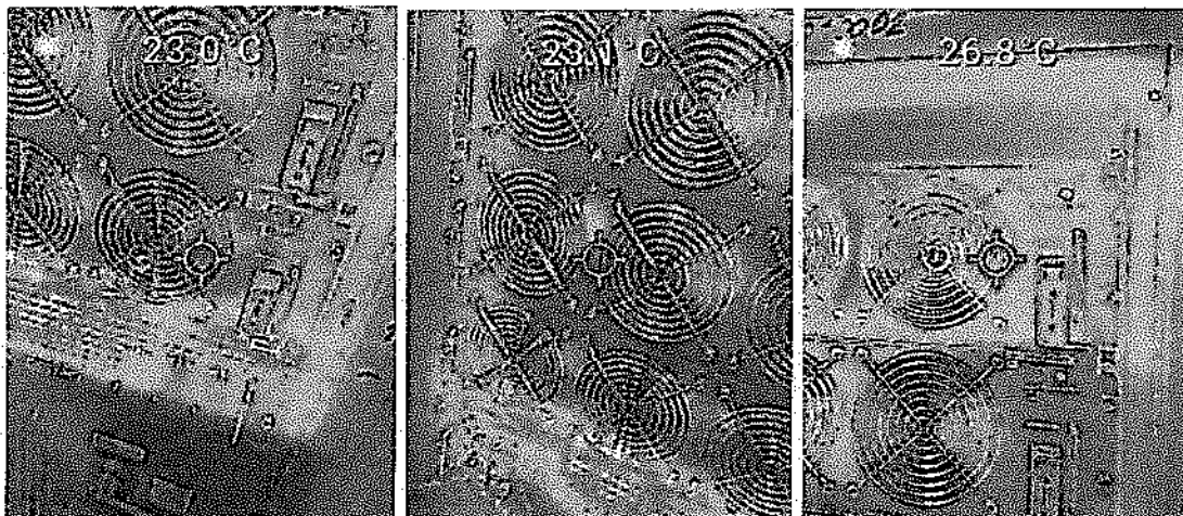
Imagen: Valor máximo medido de temperatura en los módulos de potencia del UPS
