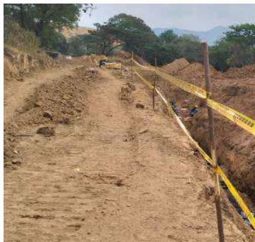
Señalización Seguridad doble linea
