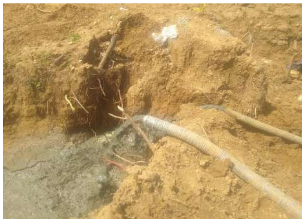
Manejo de agua filtrada en tubería de 54"
