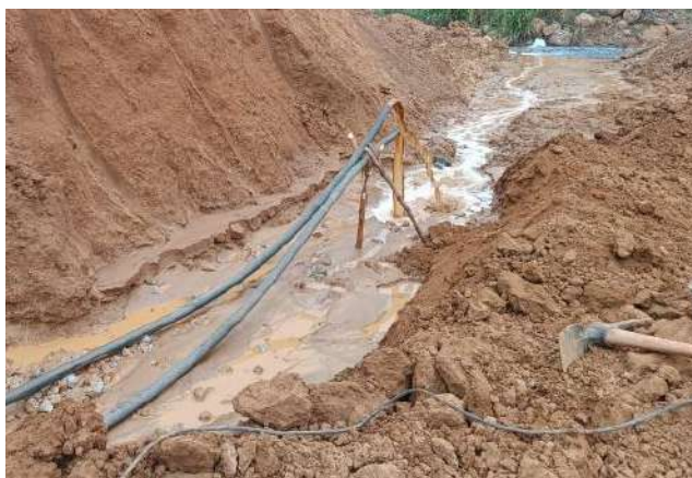
Manejo de agua filtrada en tubería de 54"
