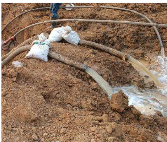
Manejo de aguas lluvias
