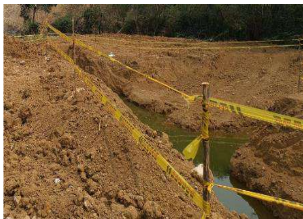
Señalización Seguridad doble linea
