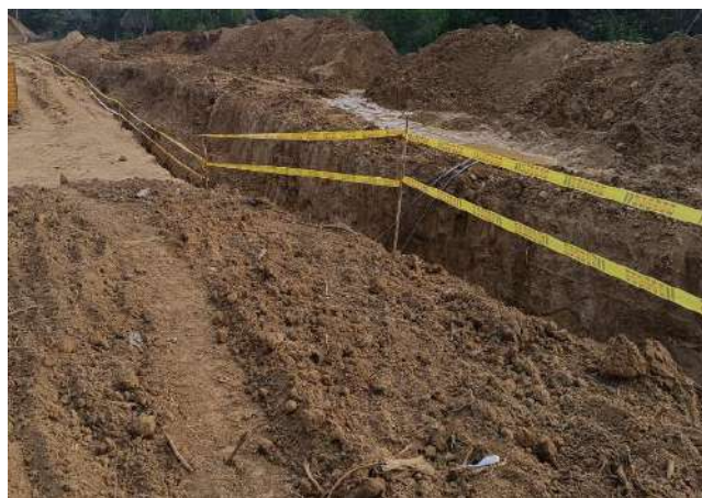
Señalización Seguridad doble linea
