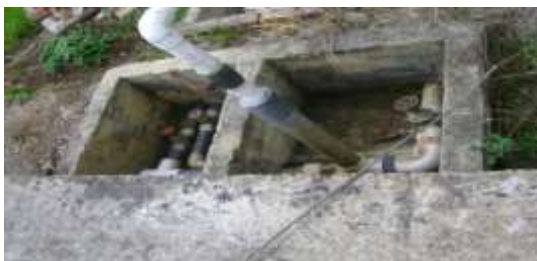
CAJA DE REGISTROS PARA DISTRIBUCIÓN
