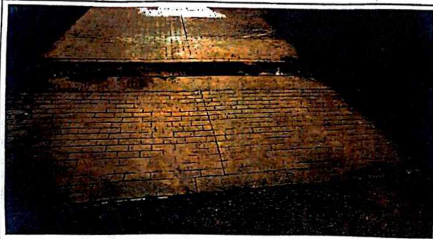
Foto No. 7 Descripción Ausencia de rejilla metálica
