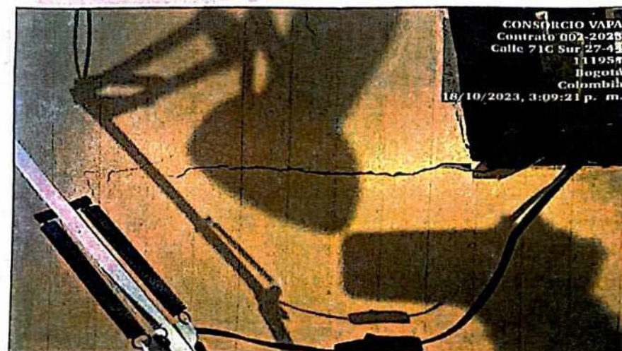
Foto No 4 Descripción SE ENCUENTRA CORDON DE ALICATA EN LA JUNTA HORIZONTAL.
