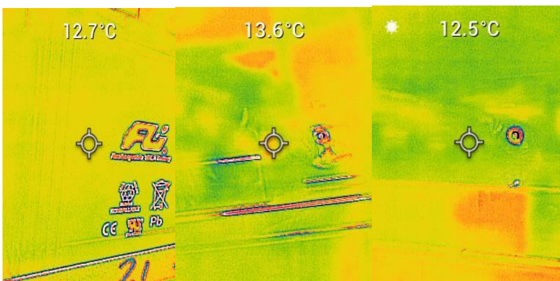
Imagen: Valor máximo medido de temperatura en las baterías del UPS
