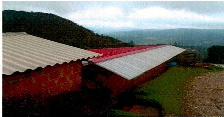
Ilustración 2 Detalle Tejado - Falla 1
