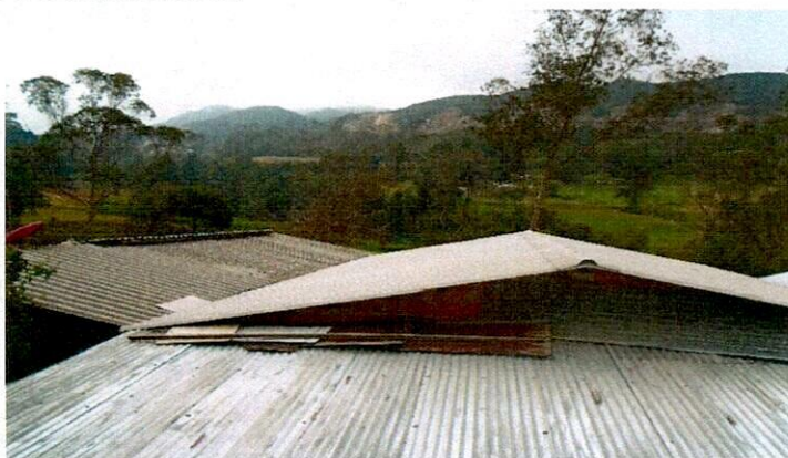
Ilustración 1 Detalle Canal - Falla 1
