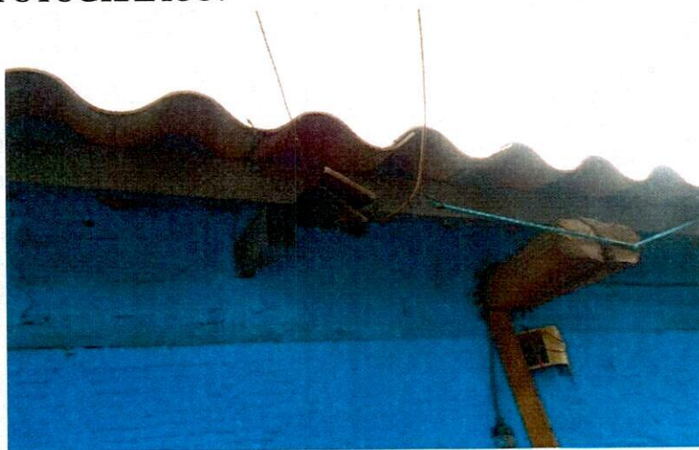
Ilustración 2 Detalle De Acometida Eléctrica - Falla 2
