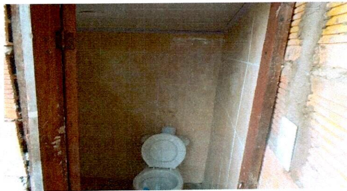
Ilustración 2 Detalle Ducha Baño - Falla 1
