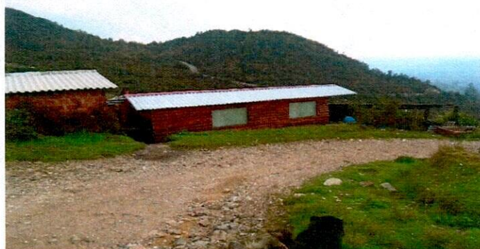
Ilustración 1 Detalle Tejado - Falla 1
