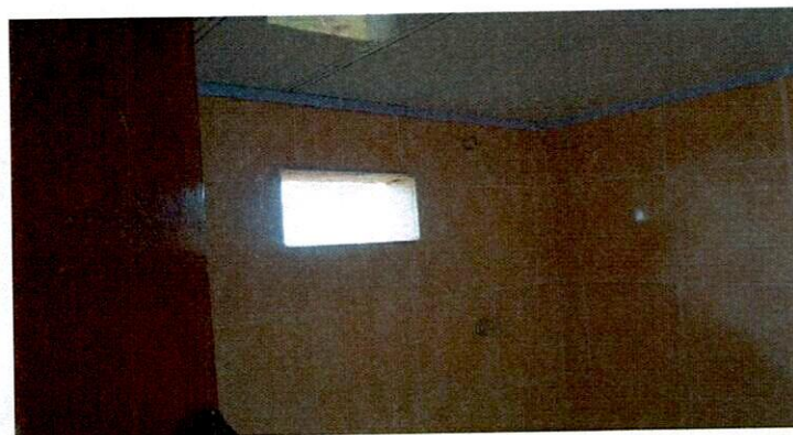
Ilustración 1 Detalle Ducha Baño - Falla 1
