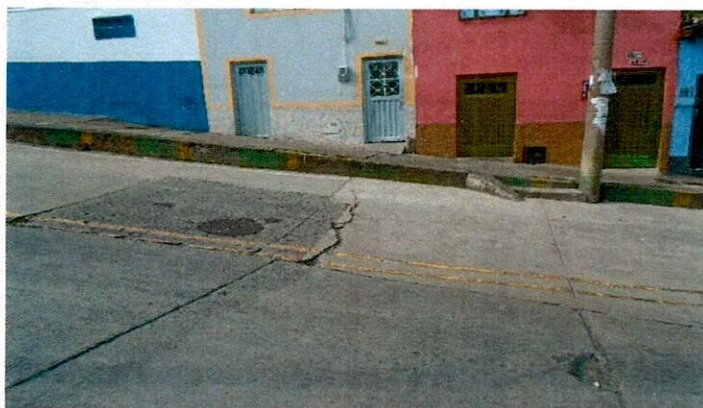
Ilustración 3 Detalle de fisura – Falla 3.
