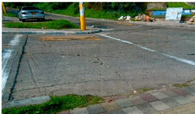
Ilustración 1 Detalle de fisura – Falla 1.
