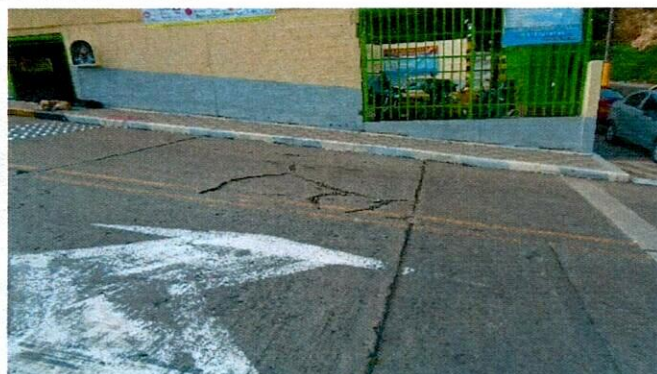
Ilustración 2 Detalle de fisura – Falla 2.
