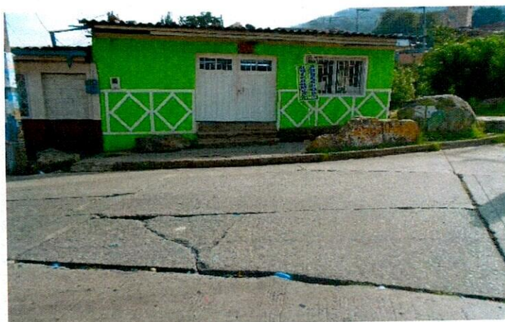
ILUSTRACIÓN 3 Detalle de fisuras – Falla 2.
