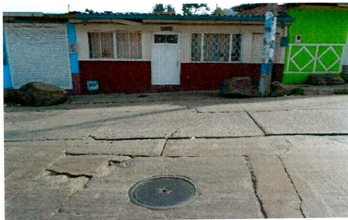
ILUSTRACIÓN 2 Detalle de fisuras – Falla 2.
