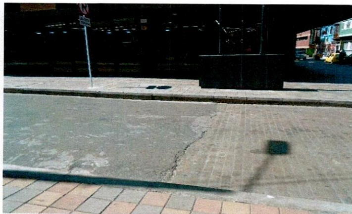
ILUSTRACIÓN 2 Detalle de junta – Falla 2.
