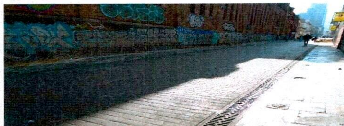
Ilustración 3 Detalle de Bolardos Retirado
