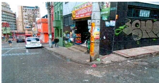
Ilustración 1 Detalle de Desprendimiento
