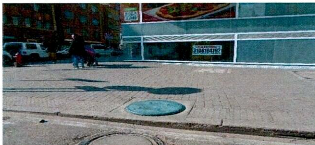
Ilustración 2 Detalle de Desprendimiento
