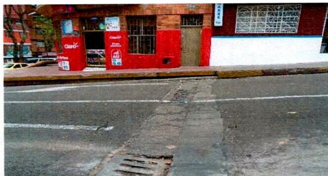
Ilustración 2 Detalle de Desprendimiento
