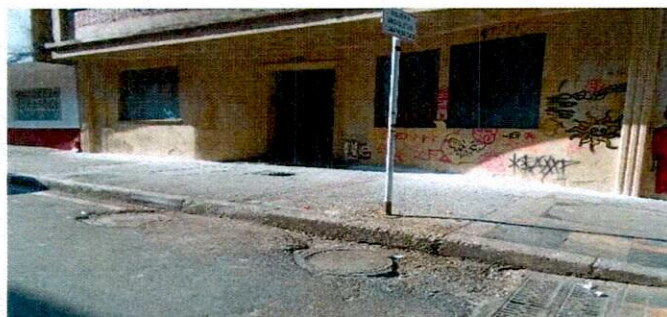
Ilustración 1 Detalle de Desprendimiento
