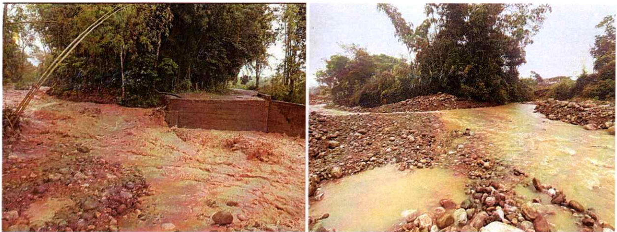
Creciente de caño sucio que afectó la protección del aproche del puente, Mesetas – Vereda Las Flores, Caño Sucio
